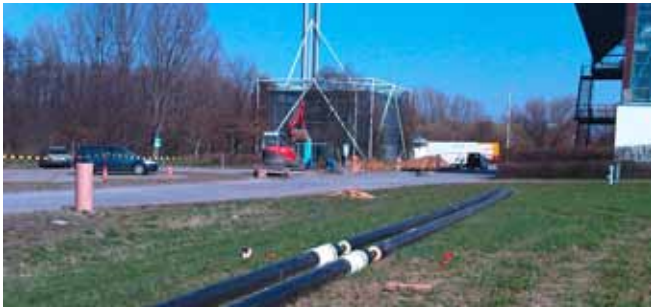
Gut vorbereitet: Wilkhahn wird künftig Biogas-Fernwärme zum klimaneutralen Heizen einsetzen.
